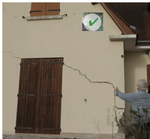
(b) Fissurations en escalier caractéristiques d'un tassement différentiel d'un ouvrage du fait du mouvement du terrain. Source : France2
