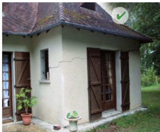
(a) Fissurations en escalier sur un angle de maison caractéristiques d'un tassement différentiel d'un ouvrage du fait du mouvement du terrain. Source : FFA (2022b)
