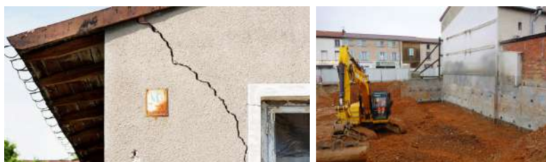
FIGURE 1.6 – Fissuration (à gauche) et reprise en sous-oeuvre (à droite)
